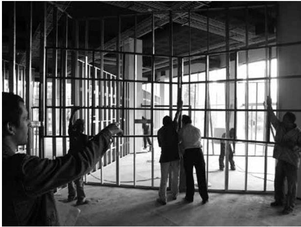
Alejandro García, museógrafo del Memorial, coordina la instalación de los muros en la planta principal en agosto de 2007 Fotografía Andrea Navarro
