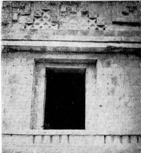
Lám. XVII. La misma puerta después de reconstruir las jambas, el dintel, la cornisa y la parte del friso.
