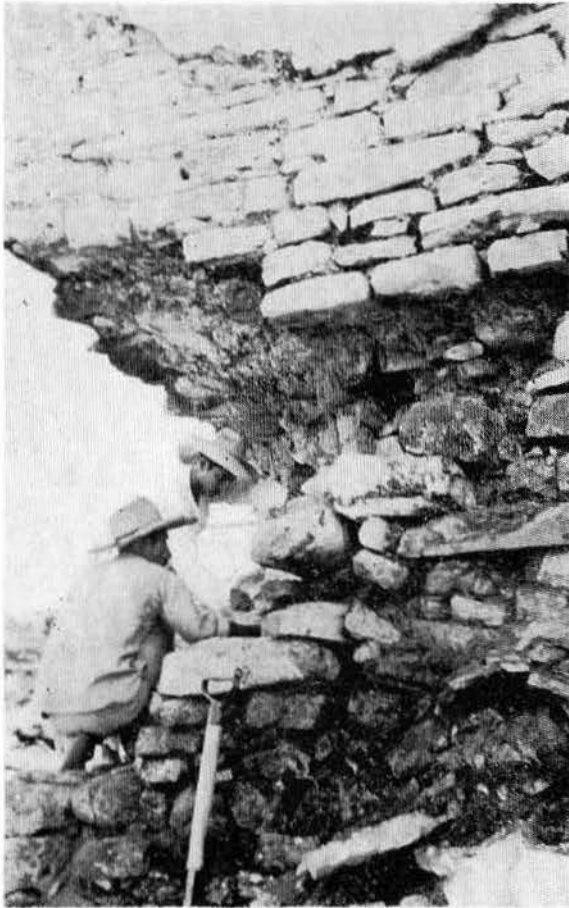
Lám. XXVII.—Esquina NO. del Templo del Conde, totalmente socavada.
