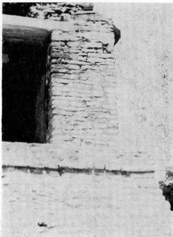
Lám. XXVI.—La misma esquina después de reconstruir el basamento y completar el muro del templo.
