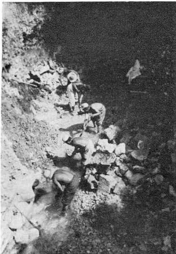
Lám. XXVIII.—Acueducto: los trabajadores recogen el escombro caído en la cala recién abierta (no se halló bóveda en este tramo).
