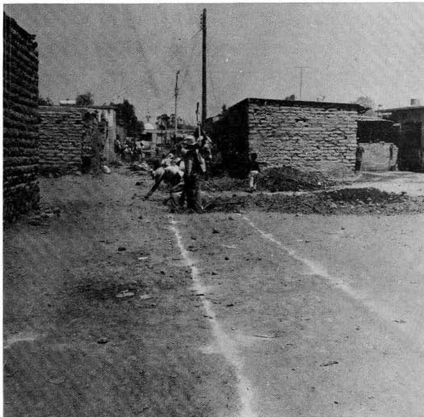
Fig 3. De acuerdo con el orden que seguían las obras de drenaje, se creó un sistema de alineación y de coordenadas
