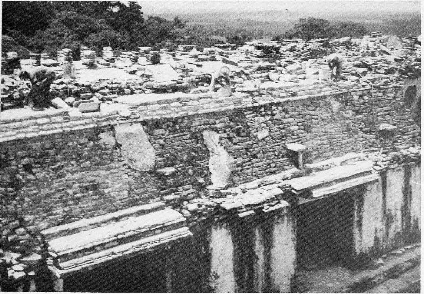
Fig 12. Para evitar que las filtraciones deterioraran las diferentes crujías o galerías que forman el conjunto conocido como El Palacio, se había empezado la restauración de los techos desde 1967. Sin embargo, el problema no terminó
