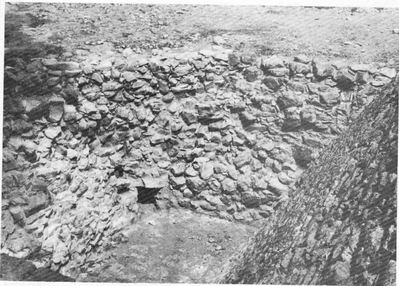
Fig 4. Con el fin de evitar la humedad que, a paso lento pero seguro, dañaba la cripta del Templo de las Inscripciones se consolidó este hoyanco de más de 2.50 m de profundidad, se enlajó el piso y se contruyó un desagüe bajo el mismo
