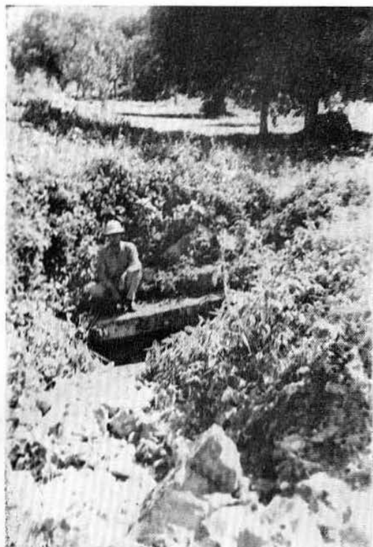
Lám. XI. Sitio en que se derrumbó la bóveda del Acueducto (antes de las exploraciones).
