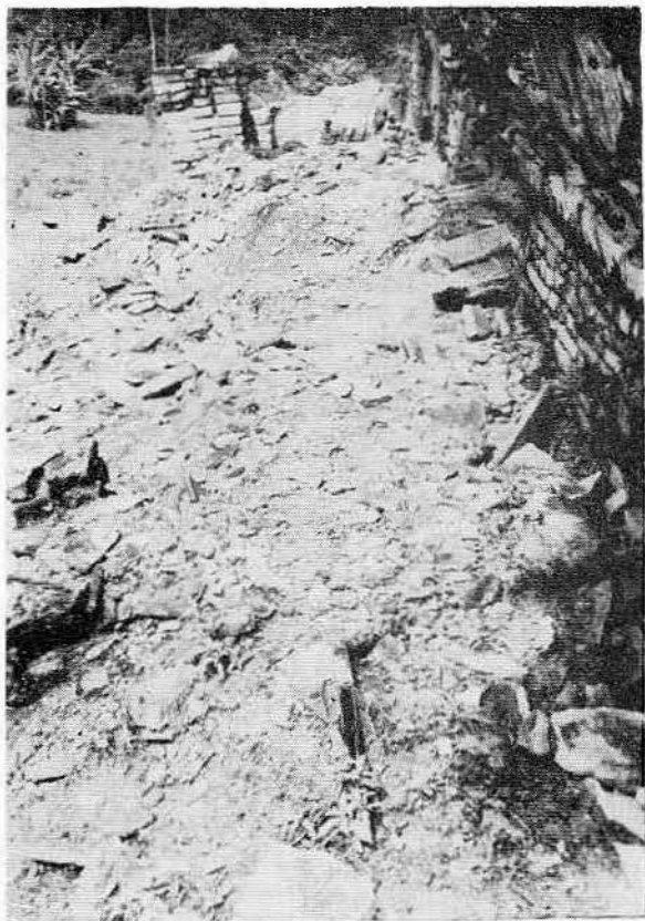
Lám. XI.—Grupo Norte: pórtico del Templo V lleno de escombros, al iniciarse la temporada.
