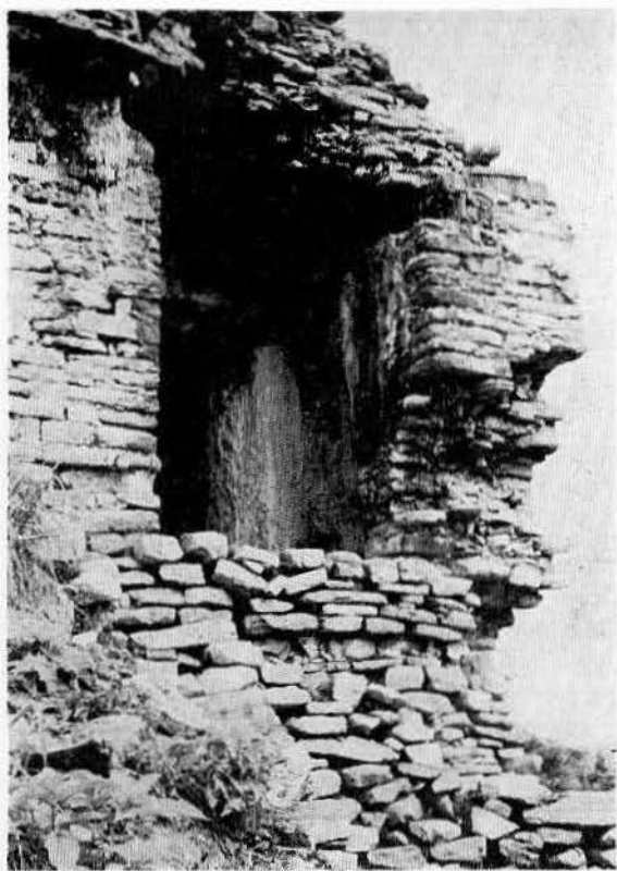
Lám. XXV.—Esquina NE. del Templo del Conde, en que se ve cómo faltaba apoyo a la construcción.
