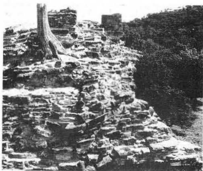
Fig 2. Siguiendo las nuevas tendencias en la restauración de edificios, se decidió consolidar el techo del Templo IV tal como fue encontrado, sin intentar la reconstrucción
