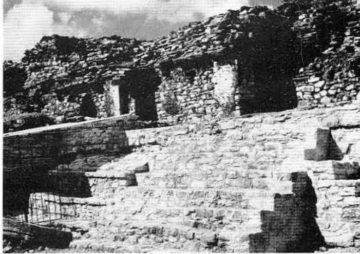
Fig 15. La misma escalera, con sus 8 escalones ya restaurados. También se trabajó en el altar estucado que se ve a un lado: sus relieves fueron limpiados y consolidados
