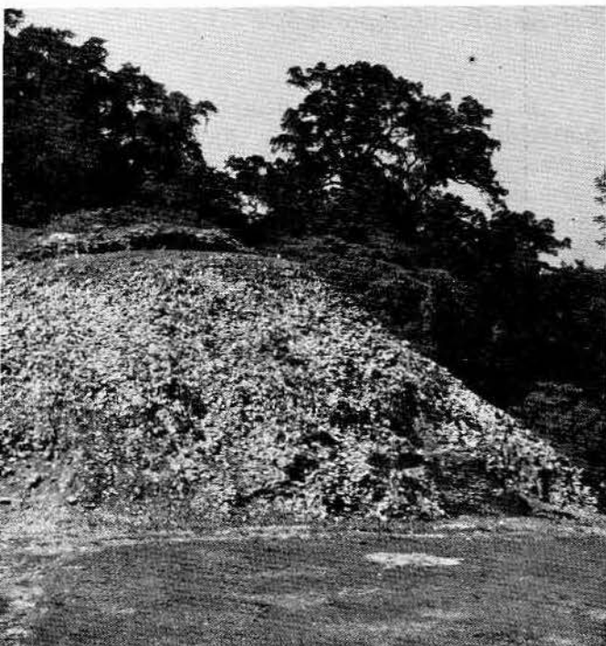
Fig 26. El Templo XI, después del desmonte realizado. El resultado fue decepcionante, pues se advirtió el terrible estado de deterioro en que se encuentra la construcción
