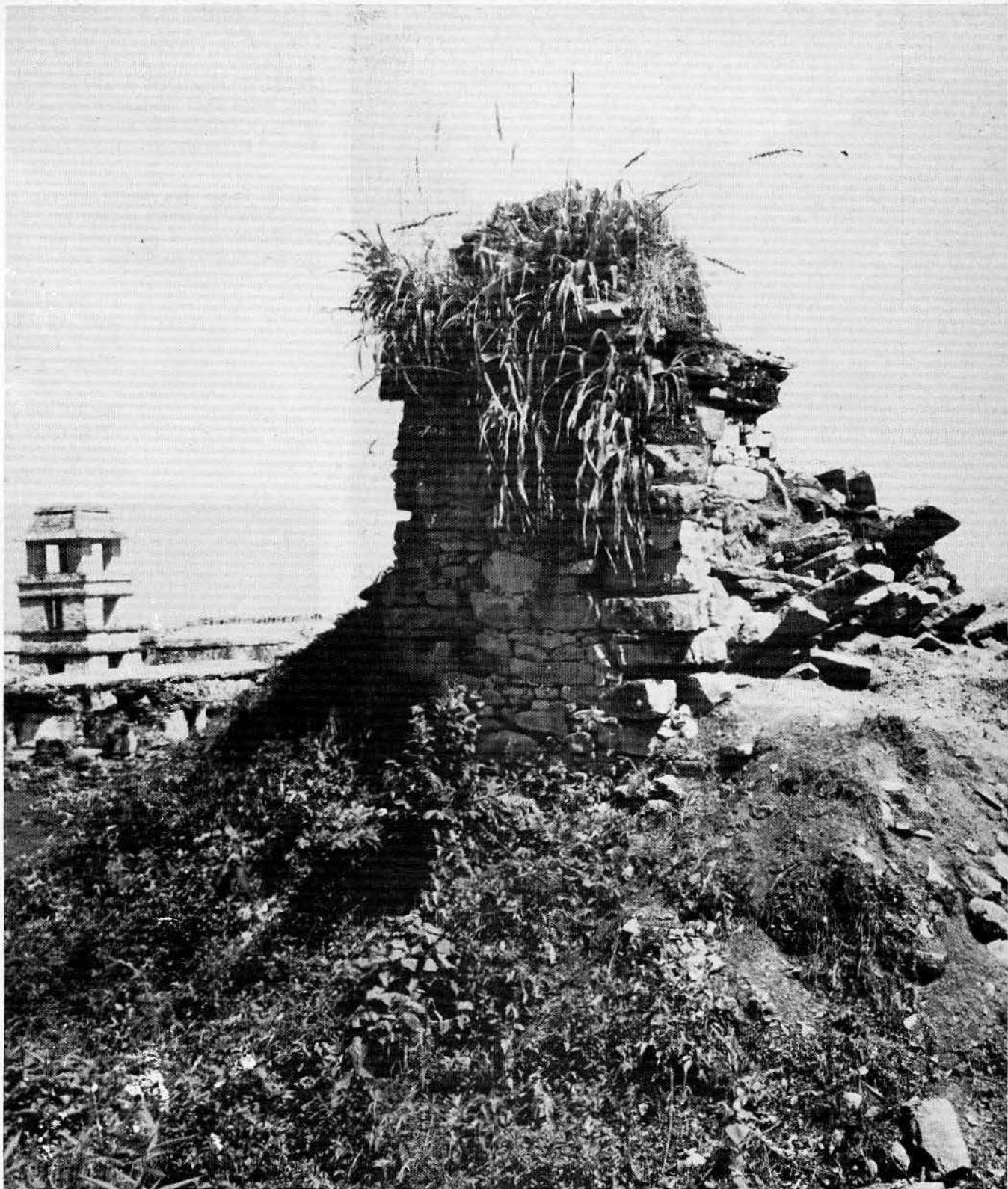
Fig 26. Esta vista general del Edificio XIV permite observar el único muro que quedó del edificio superior. La hierba del lugar causa estragos al enraizar entre las piedras del que fuera parte del bello conjunto arquitectónico maya
