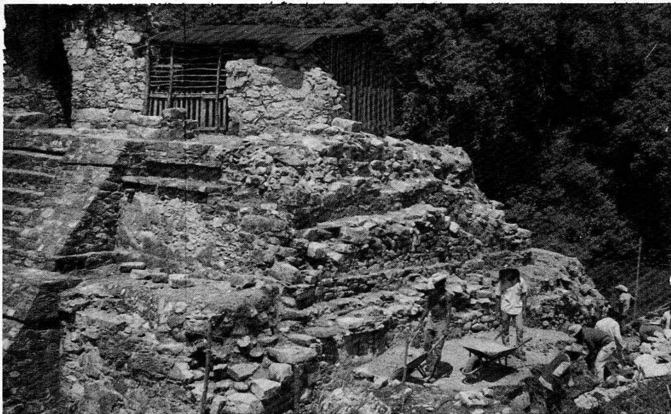
Fig 9. El lado norte del Edificio XIV justificaba las restauraciones que se harían fuera del plan de trabajo. Véase el deterioro en todos los cuerpos y compárese con el aspecto que presentaron al final de las restauraciones (Fig 10)
