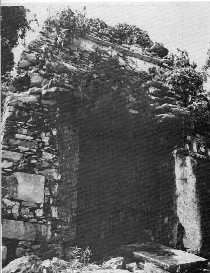
Fig 23. También el techo del Edificio XII estaba en condiciones lamentables. Algunas losas del primer arquitrabe estaban rotas y era peligroso sacarlas sin que el techo cayera; por tal motivo se decidió sólo repararlas con cemento
