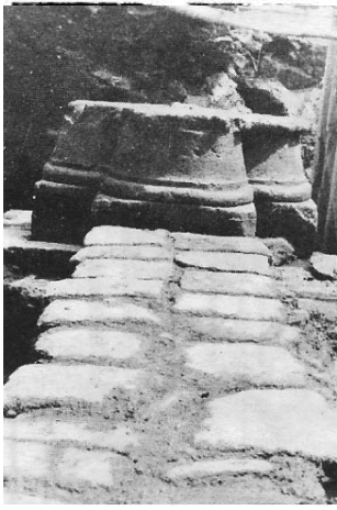
Basa de la columna de la esquina nororiental del Patio del Tribunal de Cuentas
