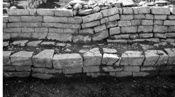
● Fig. 51. Detalle costado poniente de la plataforma y muro con asentamiento.
