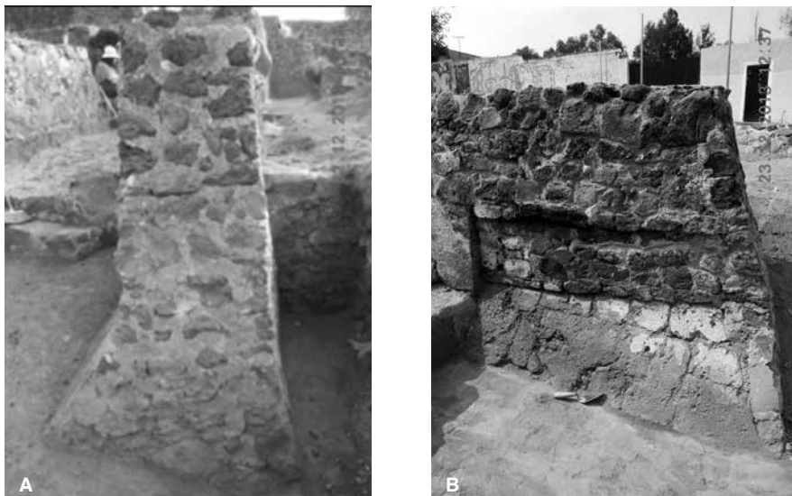
● Fig. 17 Parte final del muro, en el cual se observa las diferentes intervenciones que ha tenido en su restauración.
