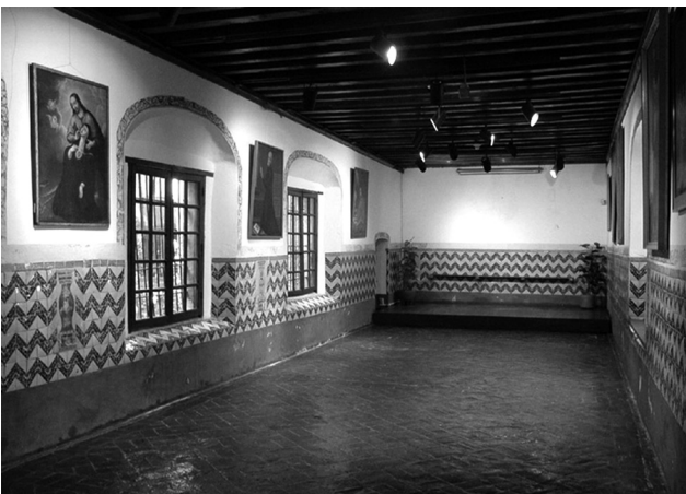
Fig. 6 Refectorio en 2004; se aprecian sales en los muros.
