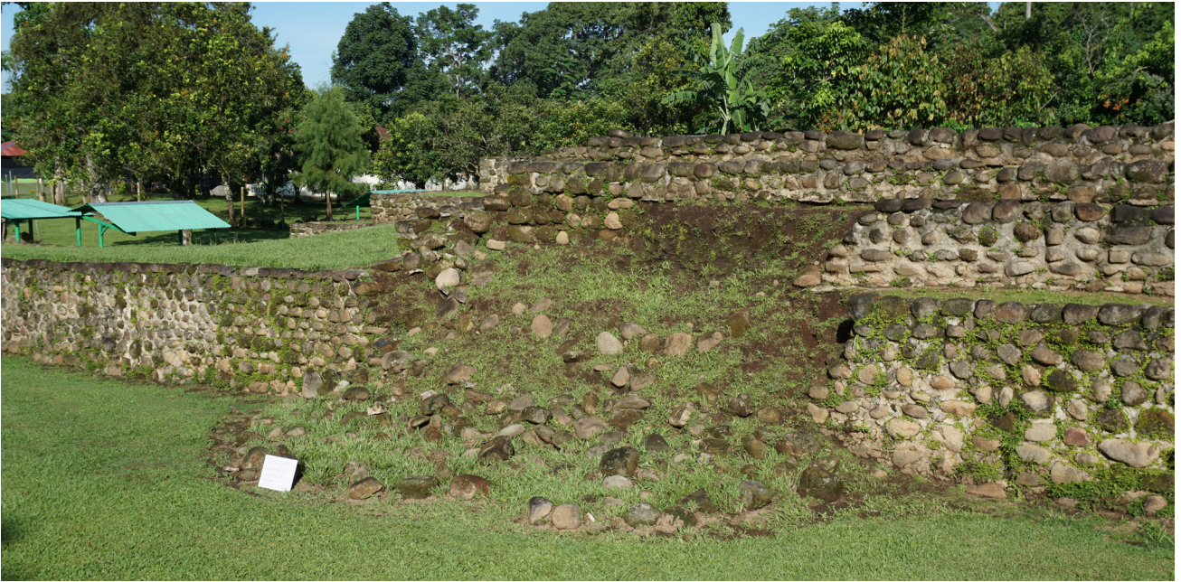
Fig. 4 Colapso de la plataforma basal de la estructura 125 y de la esquina sureste de la estructura 125-B en el Grupo F.
