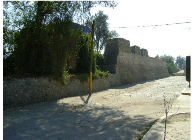
Fig. 37 Muro lateral sur de la fachada principal. Entre ambas porciones se definió el acceso principal del recinto, el cual puede observarse justo donde se encuentra el poste del cableado eléctrico.
