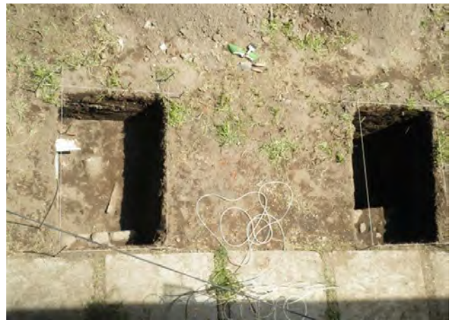
Fig. 47 Vista de los restos del muro sur en los dos pozos de sondeo. Imagen tomada desde la azotea de la casa de Sr. Vega.
