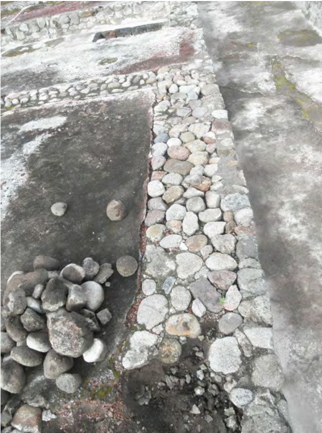
Fig. 33 (izq. arriba) Núcleo de muro medianero sin consolidar y a ras de piso. Vista de este a oeste.
