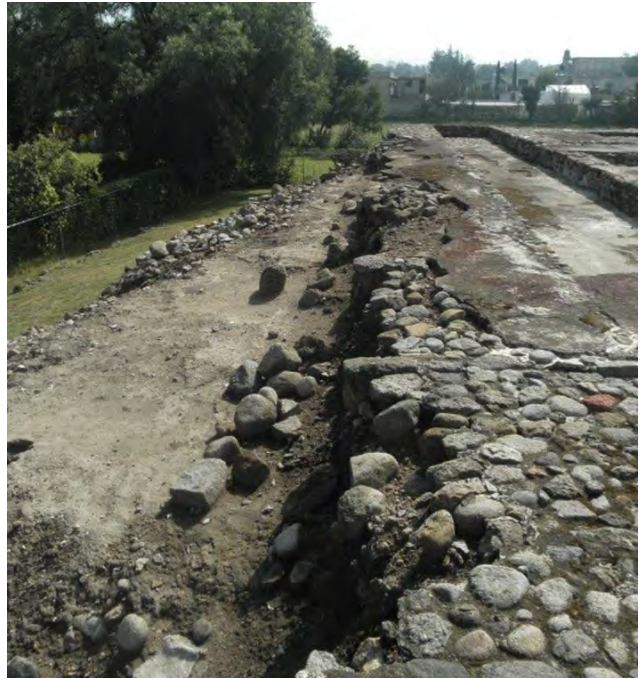
Fig. 31 Derrumbe de material constructivo del muro perimetral norte y banqueta adosada. Vista de oeste a este.
