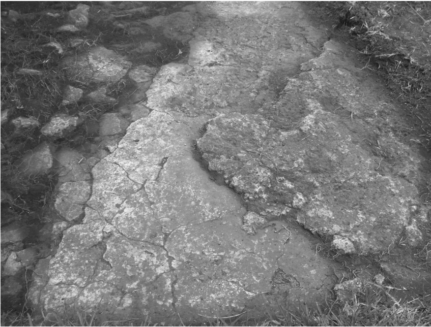
Fig. 39 Evidencia del uso de estuco frente a Estructura IX, Cuicuilco "B". Fotografía: F. Ramírez.
