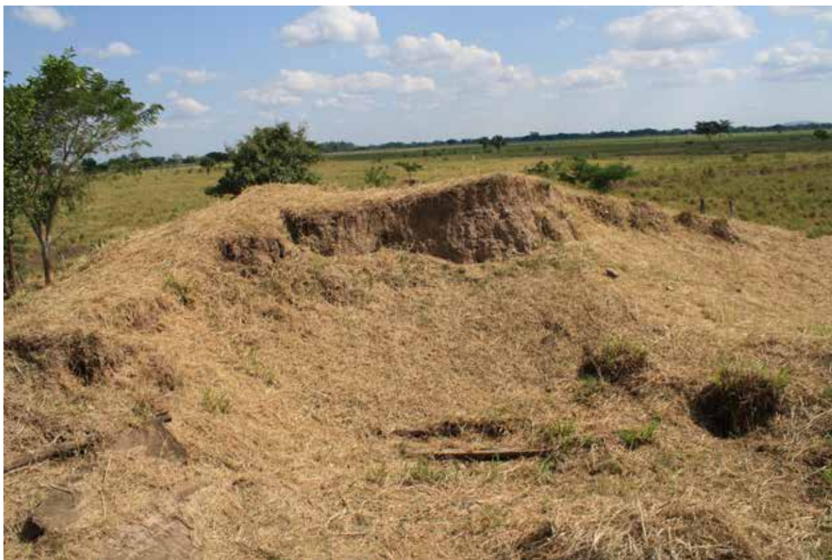
Fig. 4 Estado de conservación de la Estructura 1N antes de su intervención. Fotografía de Estela Martínez Mora.
