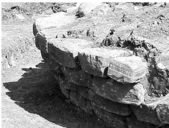
● Fig. 12 Sección vencida del talud.
