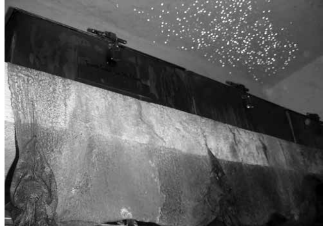
Fig. 24. Techo de la cámara con filtración de agua. Fotografía: Ma. de Lourdes López Camacho.
