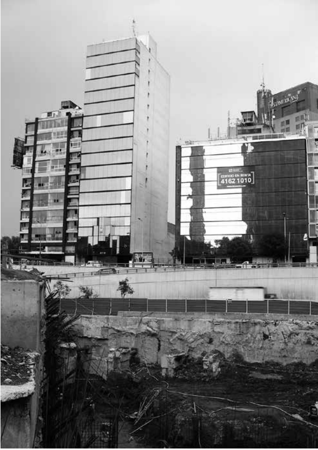
Fig. 23 Construcción de la Subestación Eléctrica Diana. Fuente: Maira Leticia Martínez Lemu, INAH.
