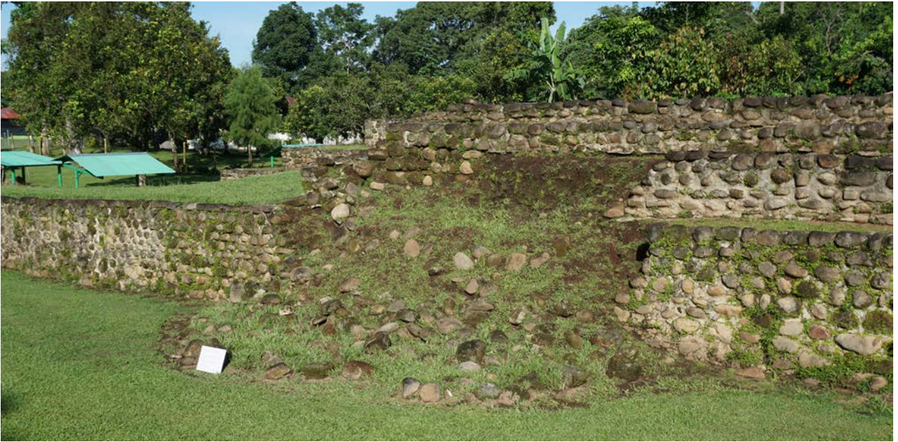
Fig. 4 Colapso de la plataforma basal de la estructura 125 y de la esquina sureste de la estructura 125-B en el Grupo F.
