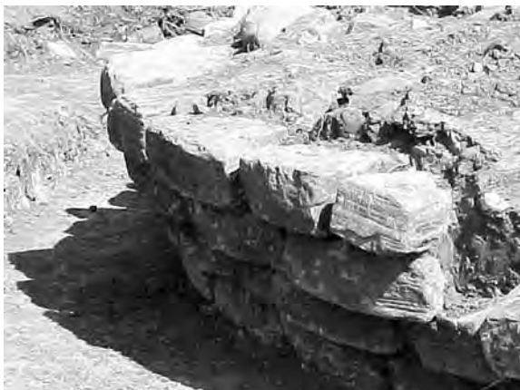
● Fig. 12 Sección vencida del talud.
