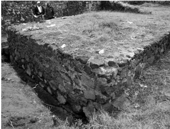
◉ Fig. 11 Muro norte de la Plataforma 1, donde se aprecia el faltante de cementante entre las piedras y sobre todo en el desplante del mismo.
