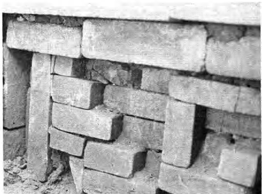
Foto 5. Vista parcial del tablero W.
