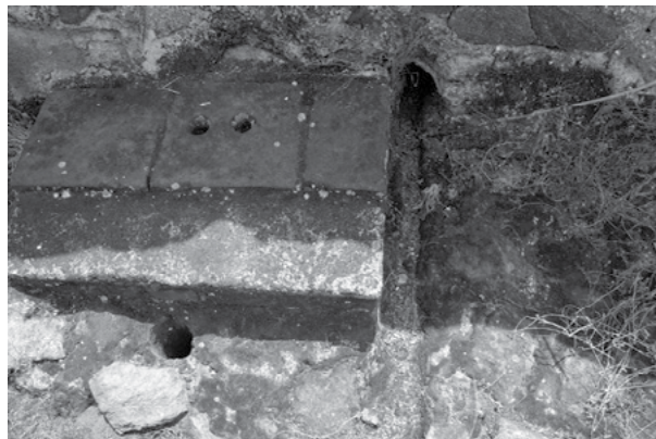
Figura 8. Cubierta de la letrina de la primera celda del aljibe 3. Se pueden ver los dos tubos de aireación de la letrina, al pie de estos, la cañería por la que bajaba el agua para limpiar el inodoro, y a la derecha el tubo de salida del agua del aljibe 3. Fotografía de Alberto Garín.
