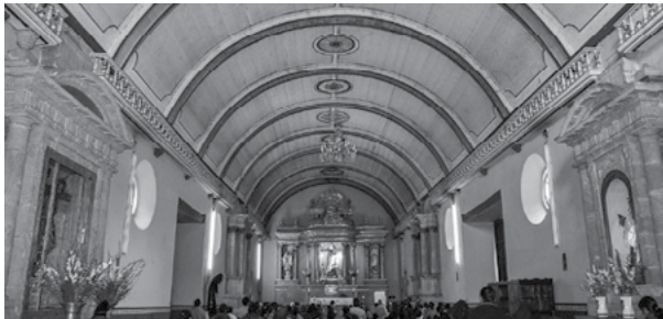
Figura 14. Bóveda de madera, templo de San Nicolás de Bari, Santa Fe. Fotografía del Archivo Torres Salomao. Esquema elaborado por Luis Alberto Torres.
