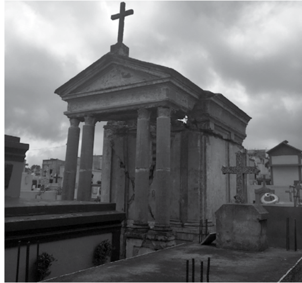
Figura 6. Cementerio de San Marcos con daños, a consecuencia de los sismos del 2012. Fotografía de Susana Palma, 2015.
