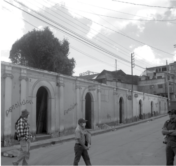
Figura 5. Locales de San Marcos con graves daños, a consecuencia de los sismos del 2012. Fotografía de Derson de La Cruz, 2012.
