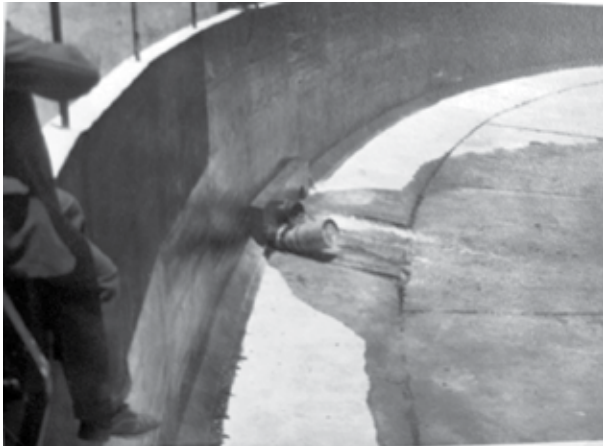
Figura 16. La gran pileta, tanque o contenedor de agua inicia su llenado; millones de litros de agua necesariamente pura serán utilizados para la elaboración de la celulosa. Colección Alberto Lenz Krahl.
