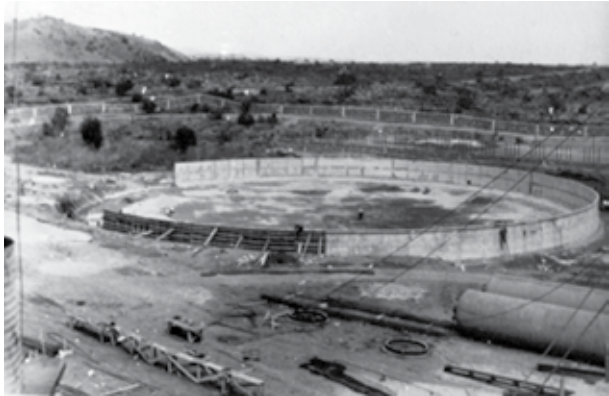
Figura 3. Avances constructivos de la tina. Los muros son prefabricados en secciones y posteriormente montados. Colección Alberto Lenz Krahl.
