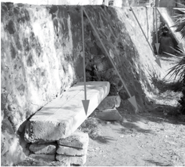
Figura 4. Contrafuertes de la cortina al lado oriental de la presa. Fotografía de Diana Martínez y Bradley Skopyk.
