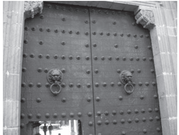
Figura 4. Parte de las dos hojas que conforman el portón, con los remaches, aldabones y el acceso cotidiano por la pequeña puerta. Fotografía de Elsa Hernández Pons.
