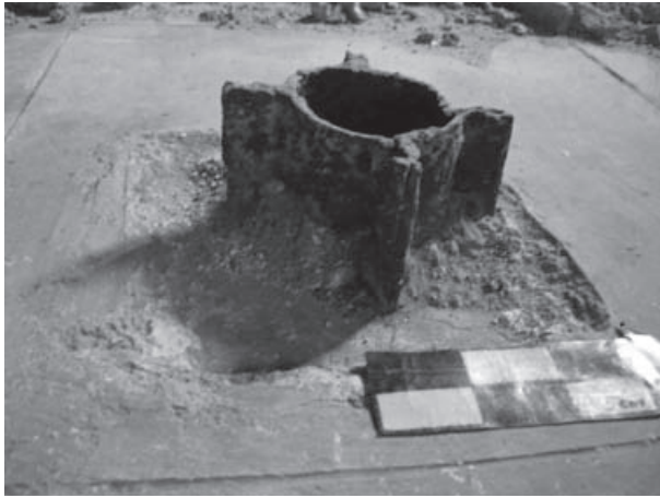
Figura 23. Columna recortada en su base, para introducir un nuevo piso dentro de Moneda 13. Elsa Hernández Pons y Braulio Pérez Mora, "Columnas metálicas en la arquitectura de Moneda 13", en prensa. Fotografía de Elsa Hernández Pons.
