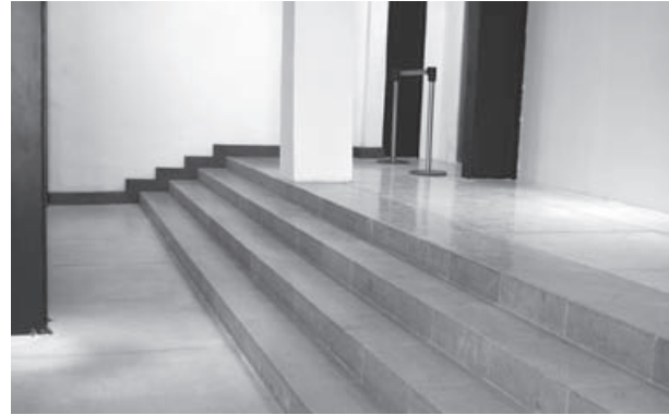
Figura 21. Imagen que muestra la obra ya concluida y los cuatro escalones o peldaños, sin pasamanos para el acceso de discapacitados. Irónicamente, el argumento para colocar dicho elevador sería para dar servicio a imposibilitados y movimiento de colecciones; no tiene rampa, sino cuatro escalones. Fotografía de Elsa Hernández Pons.
