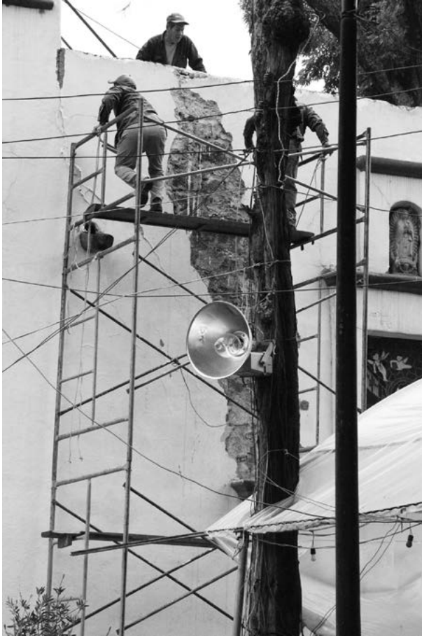
Figura 16. Tratamiento de la fractura en la fachada. Fotografía de Salvador Ávila Gaytán, 2015.
