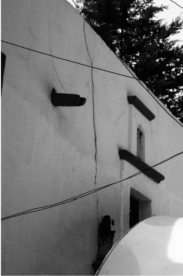
Figura 4. Fisuras y grietas en la parte superior de la fachada principal. Fotografía de Rogelio Vargas Villanueva, 2014.
