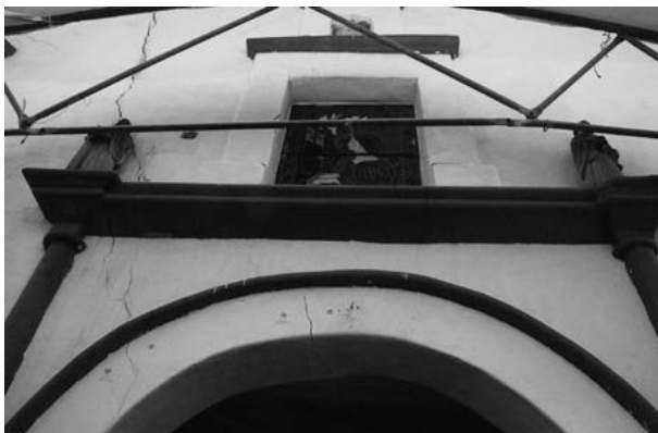
Figura 12. Grietas y fisuras en la fachada principal. Fotografía de Salvador Ávila Gaytán, 2015.
