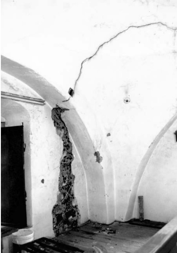
Figura 22. Tratamiento de la fractura en el muro de fachada a base de remamposteo e inyección, vista desde el interior del coro. Fotografía de Rogelio Vargas Villanueva, 2015.
