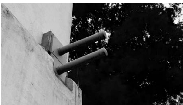
Figura 21. Caja de sensores sobre el eje 1 para tomar fuerzas de tensión en el muro de la fachada. Fotografía de Rogelio Vargas Villanueva, 2015.
