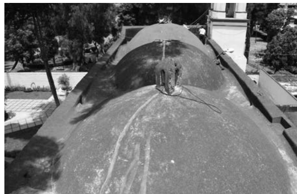
Figura 13. Grieta sobre la bóveda de la cubierta. Fotografía de Salvador Ávila Gaytán, 2015.
