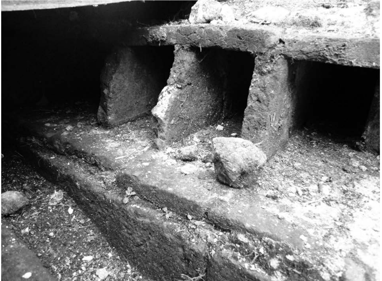
Figura 6. Sistema constructivo a base de ladrillo que provoca el aligeramiento en los rellenos de las bóvedas, además de aislamiento térmico e hídrico. Fotografía de Daniel Pastrana.
