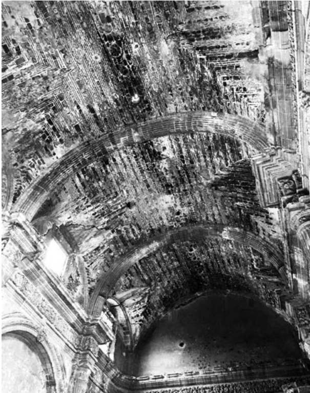
Figura 11. La bóveda de tezontle alternada con ladrillo, con lunetos, del ex templo del Hospital de San Lázaro, se hallaba deteriorada pero hoy en día está en buenas condiciones. Es similar en diseño a la del templo de San Lorenzo: una bóveda de cañón corrido con lunetos y arcos torales. Fotografía de Leopoldo Rodríguez Morales, 2016.
