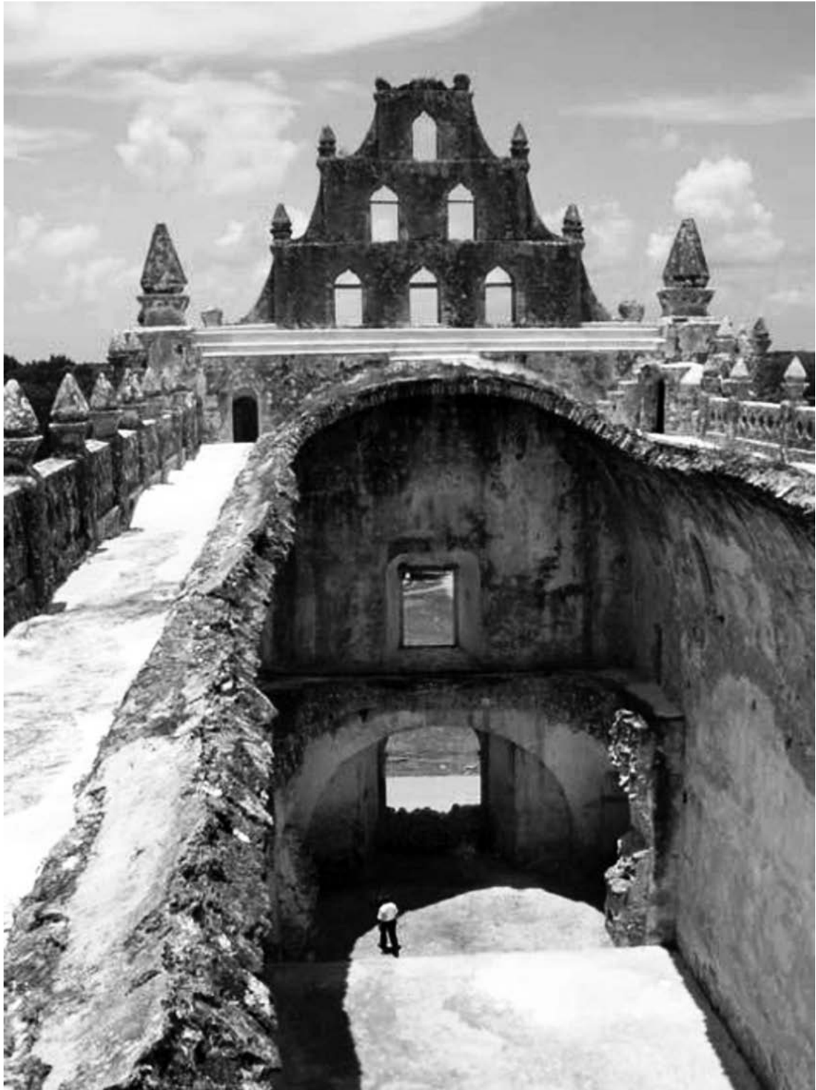
Figura 3. Vista de la nave destechada hacia 2003, donde se observa el deterioro de la iglesia conventual de San Antonio, Uayma, Yucatán. Fotografía tomada de Martha Pacheco, 2007, p. 22.
