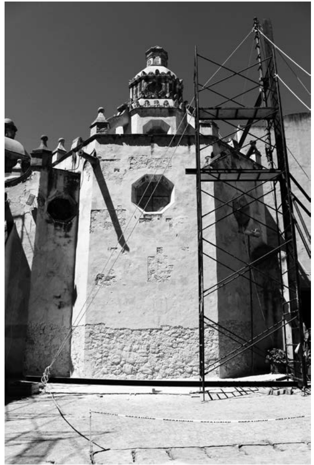
Figura 3. Vista general del muro este, en proceso de eliminación de aplanado, 2016. Fotografía de Disar. Arquitectura y Diseño.
