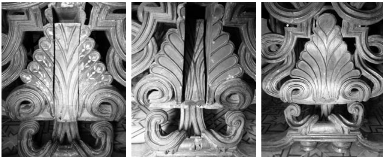
Figura 3. Comparativa en la que se muestran los daños e intervenciones que han sufrido los soportes. De izquierda a derecha vemos los faltantes, las puertas vencidas o la total sustitución de los elementos, además, se puede apreciar la pérdida de las florecillas incrustadas que dejan ver la madera clara, pulida y renovada. Fotografías de Marte González Ramírez, 15 de octubre de 2015.
