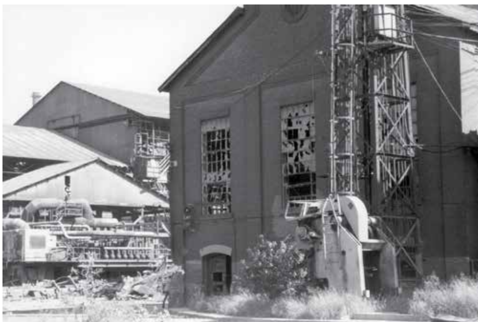
Figura 25. Fachada oeste en mal estado de la Planta Convertidora. Fotografía: anónimo. AHF, s.f.
