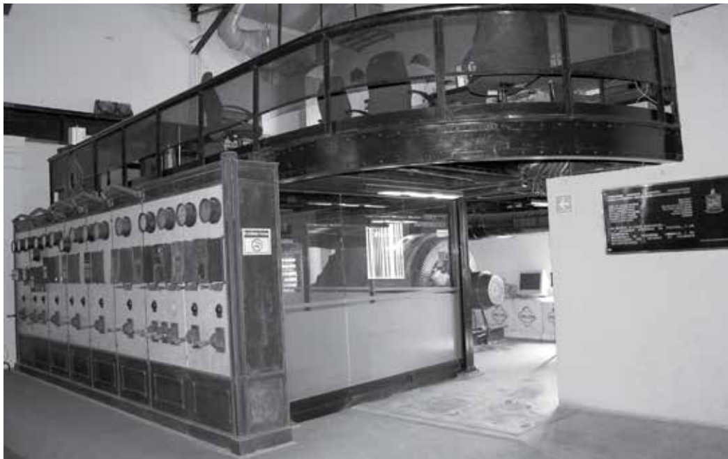
Figura 30. Mezanine sobre el generador Reliance al fondo. Fotografía: Alberto Casillas, 2018.
