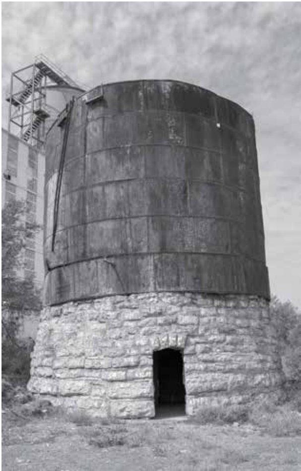
Figura 13. Tanque de agua, estación Hidalgo.
