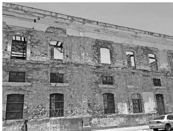
Figura 24. Imagen de mayo 2017 de la fachada de la Avenida Miguel Hidalgo, con un estado avanzado de deterioro. Expediente Técnico, Sección de Monumentos Históricos, Centro INAH Veracruz.
