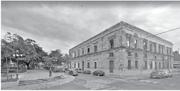
Figura 26. Imagen actual de las fachadas de las avenidas Miguel Hidalgo y Miguel Lerdo a 14 años de haber retirado el aplanado y cubierta, por inicio de obras de restauración después abandonadas. Expediente Técnico, Sección de Monumentos Históricos, Centro INAH Veracruz.
