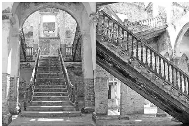
Figura 22. Deterioro actual de la escalera por el retiro de aplanados y cubierta después de iniciada y abandonada la obra de restauración. Expediente Técnico, Sección de Monumentos Históricos, Centro INAH Veracruz.
