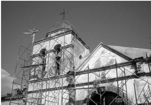
Imagen 8 y 9. Últimos trabajos realizados en la torre campanario y fachada principal de la capilla de Nogueras, aplanados y pintura a la cal. Archivo de la Sección de Monumentos Históricos del Centro INAH Colima, 2004.
