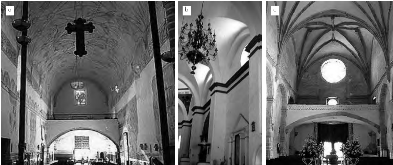
Figura 3. Tipos de bóvedas: a) Cañón corrido sin arcos, Catedral de Cuernavaca. b) Cañón con lunetos, Templo Santiago Apóstol, Jiutepec. c) Cañón de nervaduras, Templo Santo Domingo, Oaxtepec. Fuente: visita de campo (Natalia García).
