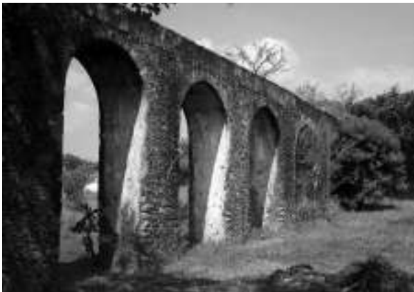
Figura 18. Acueducto de la hacienda minera de San Juan Bautista, siglo XIX, Taxco, Guerrero. Fotografía de Yolanda D. Terán Trillo, 2008.
