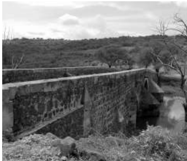
Figura 6. Pretil del puente de Calderón, desde el norte, apreciándose todavía una leve pendiente, suavizada por modificaciones, que se notan en su mampostería. Fotografía de Guillermo Boils Morales, agosto de 2006.
