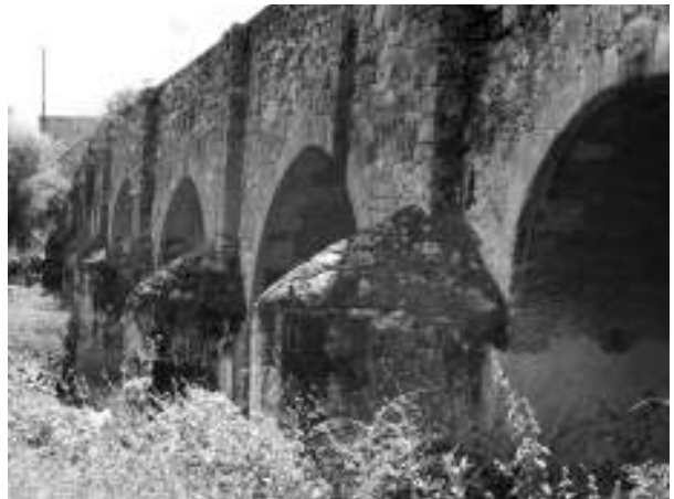
Figura 2. Vista desde el noroeste del puente de San Ignacio, Aguascalientes. Fotografía de Guillermo Boils Morales, julio de 2006.
