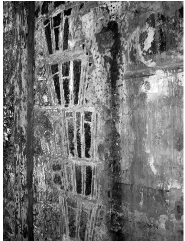
Figura 10. Solución a las grietas causadas por sismo, llamada “costura”; la imagen muestra una costura hecha en 1996. Información proporcionada por el arquitecto Benjamín Pedro Cuéllar Martínez, Coordinación Nacional de Monumentos Históricos. Foto de Leopoldo Rodríguez, 2010.
