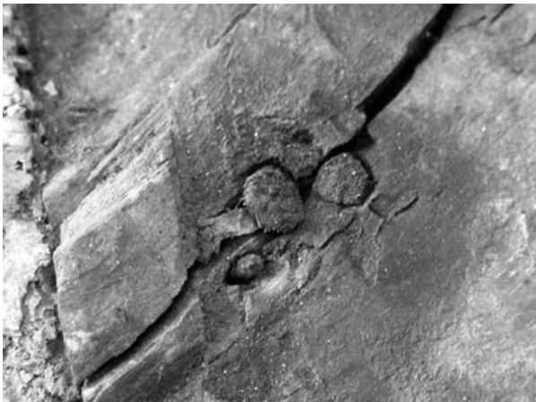
Figura 13. Detalle de la pieza 2C. Se observa cómo la oxidación de los clavos provocó fisuras en la madera.
