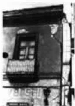
Grietas verticales (tensión).
