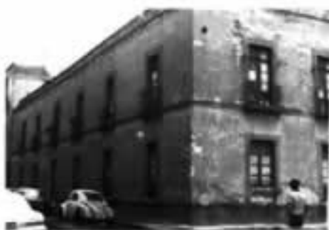
Vivienda afectada en la calle de Echeveste, ciudad de México (sismo 1909-1985). Fotografía de la Fototeca de la Coordinación Nacional de Monumentos Históricos, INAH.
